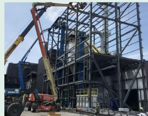
砂の再生処理装置
